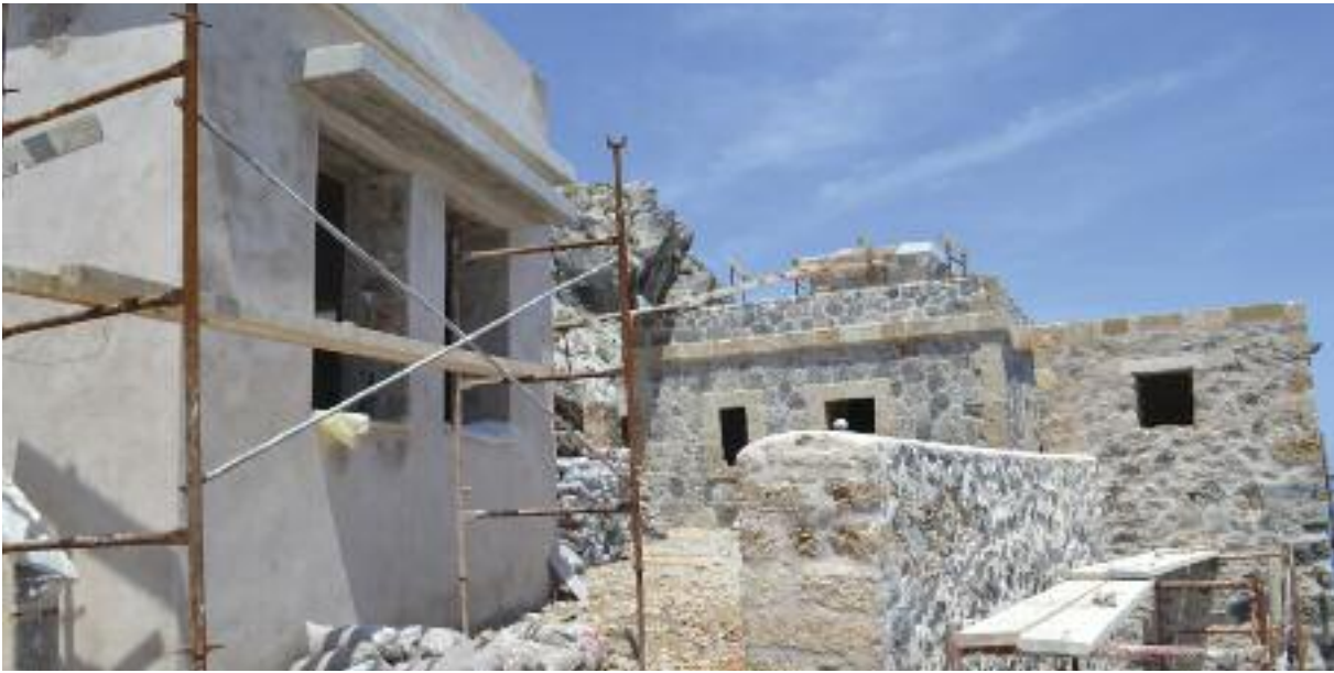
Ο φάρος κατά τη διάρκεια της αποκατάστασης. View of the lighthouse during the restoration works.
