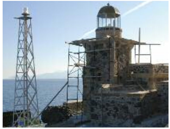
Ο πύργος με τον κλωβό και τον μεταλλικό οβελό. View of the tower with the light head on top and the nearby existing metal frame.
